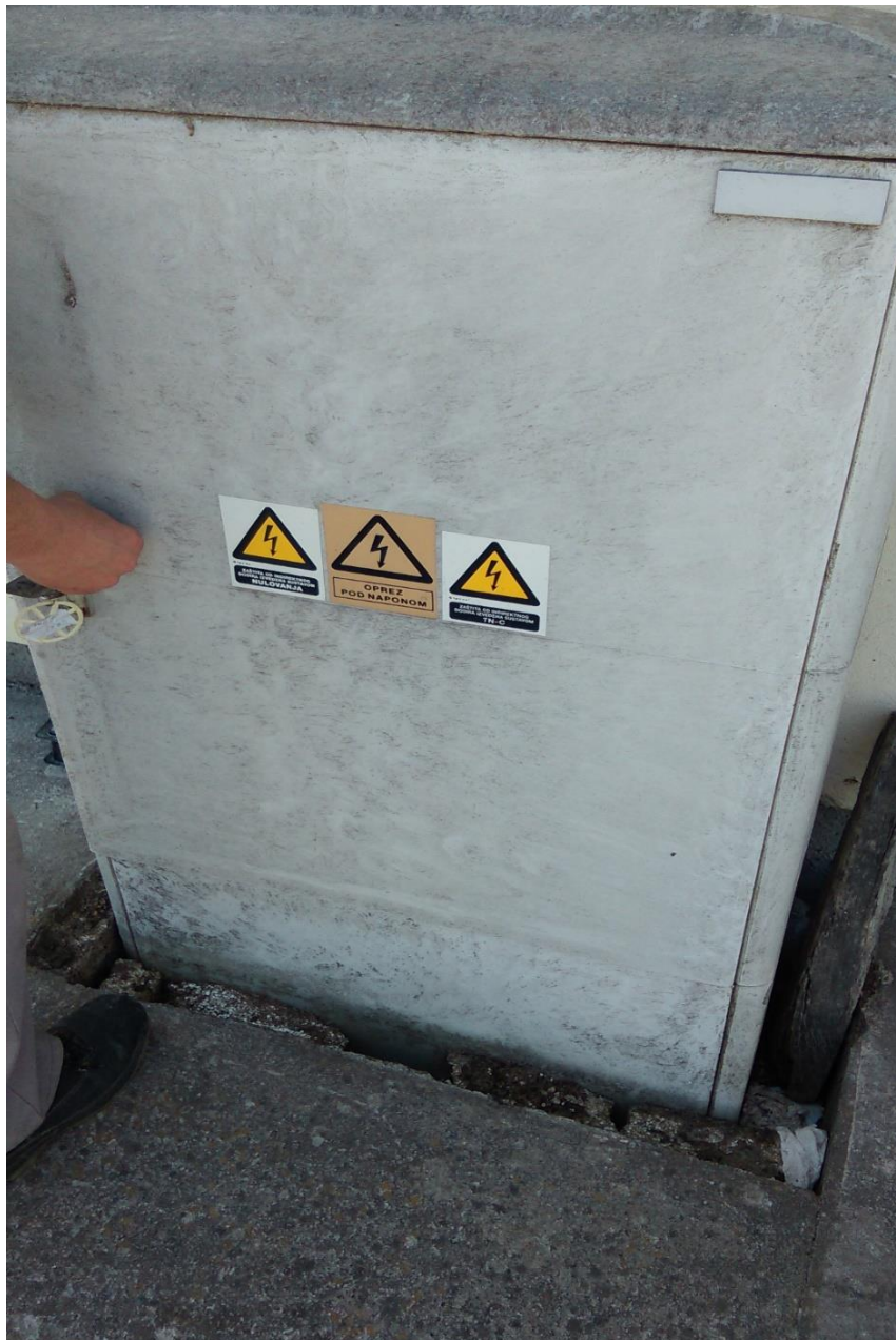
Slika 7.18. Vanjski izgled razvodnog ormara =NRO2
