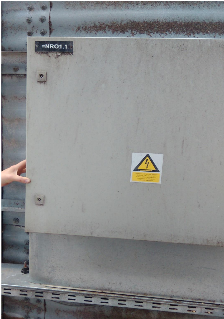
Slika 7.13. Vanjski izgled razvodnog ormara =NRO1.1
