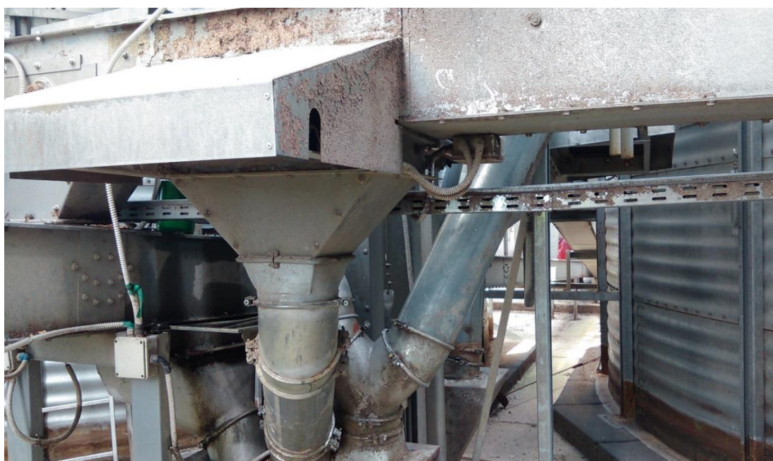
Slika 2.13. Usmjeritelj žitarica u ćelije silosa
