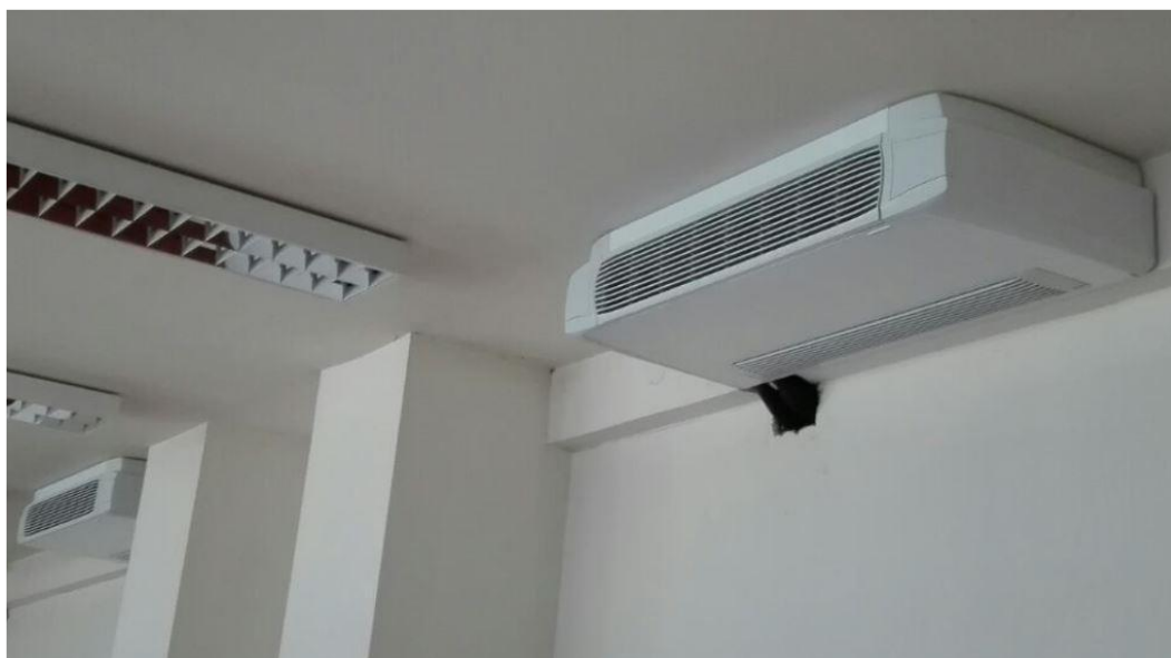
Slika 4. Ventilokonvektor u učionici S5
