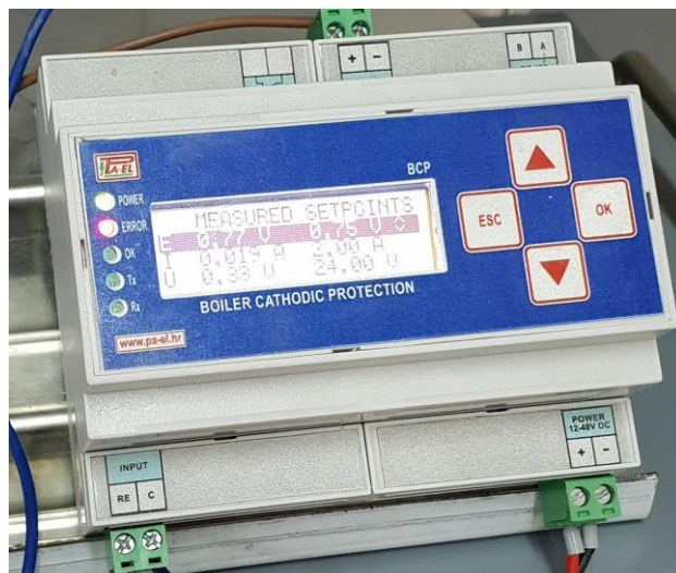
Slika 32. Detaljan prikaz upravljačke jedinice s vidljivim parametrima katodne zaštite
