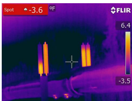
Slika 10.11 Termo sifoni snimljeni termo kamerom [81]
