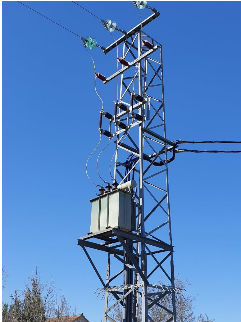
Slika 7: Fotografija distributivnog transformatora
