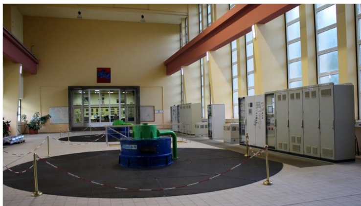
Slika 5: Unutrašnjost strojarnice HE Peruća (Izvor: [9])
