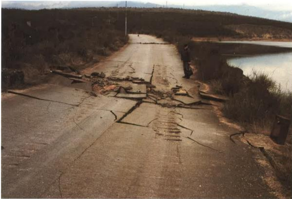
Slika 11: Ulegnuće krune brane (Izvor: [4])
