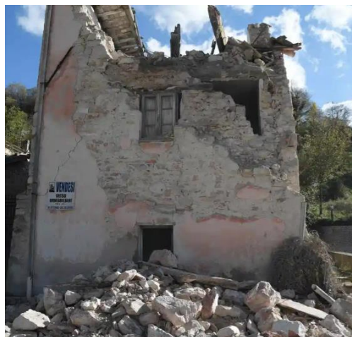
Slika 9. Djelomično prevrtanja zida nakon potresa u Italiji [15]
