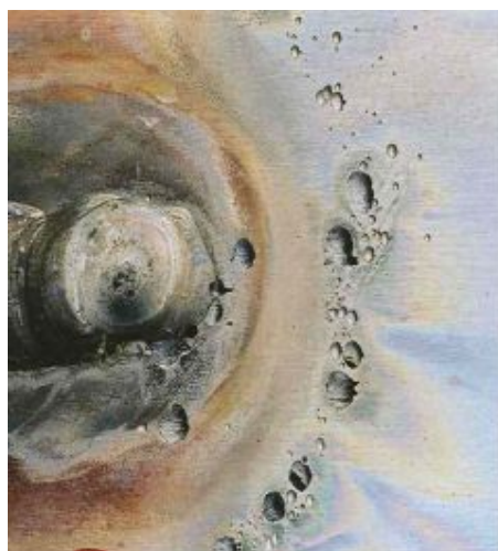
Slika 15. Jamičasta korozija nehrđajućeg čelika [16]
