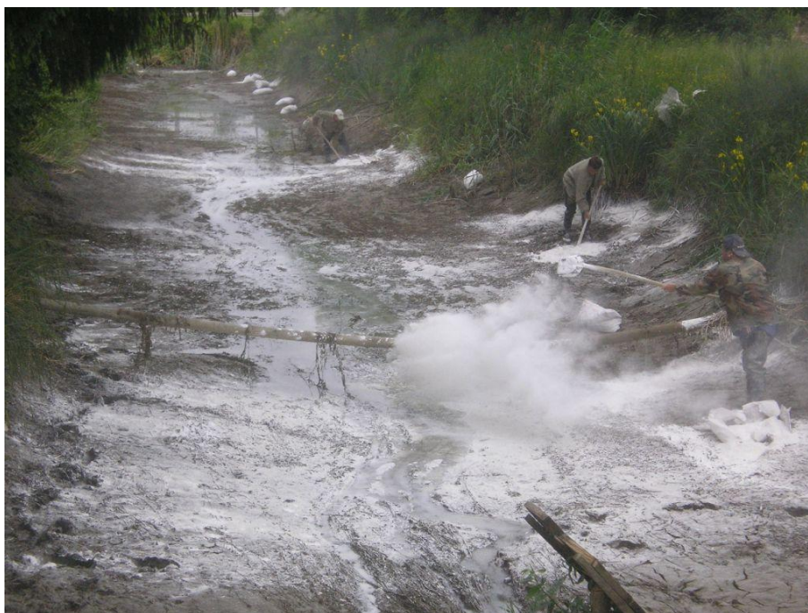
Slika 2. Vapnjenje dovodnog kanala
