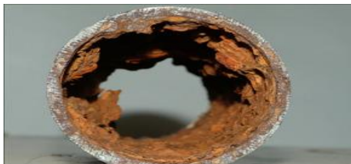
Slika 3-8. Korozija cjevovoda uzrokovana mikrobiološkim djelovanjem ( www.sciencedirect.com , 08.07.2020.).
