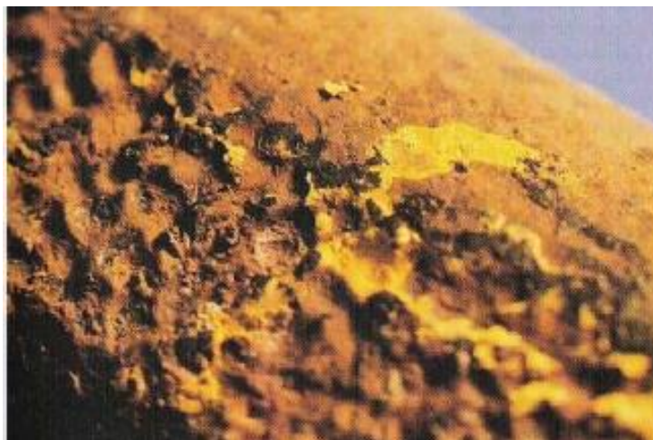
Slika 3. Primjer visokotemperaturne kemijske (plinske) korozije na vanjskoj stijenci pregrijačke cijevi parnog kotla [7]
