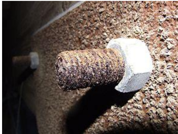
Slika 5. Primjer elektrokemijske korozije čelika u dodiru s vodom (kiša, snijeg) [9]
