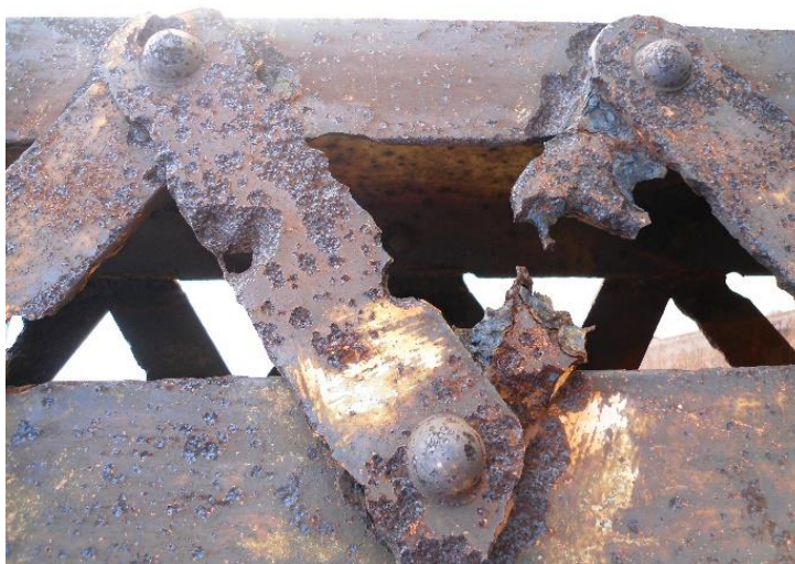
Slika 11. Primjer pjegaste korozije poprečnog nosača mosta [14]
