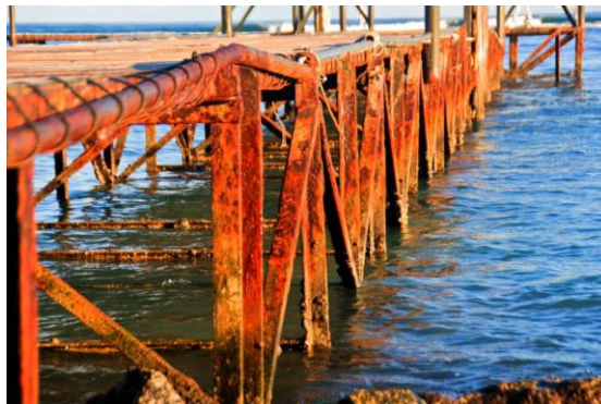
Slika 18.: Primjer utjecaja morske vode na koroziju [18]
