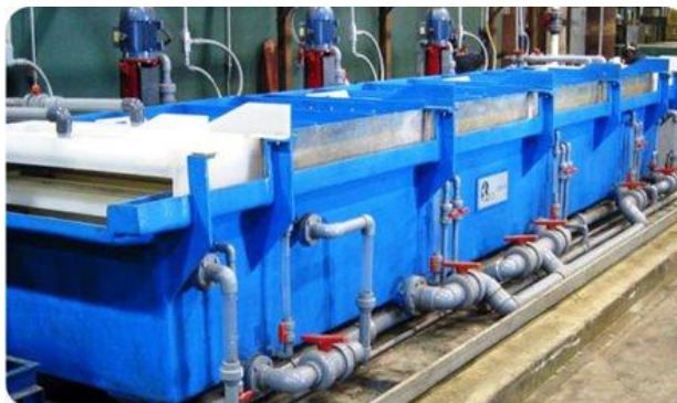
Slika 43.: Postrojenje za dekapiranje [36]
