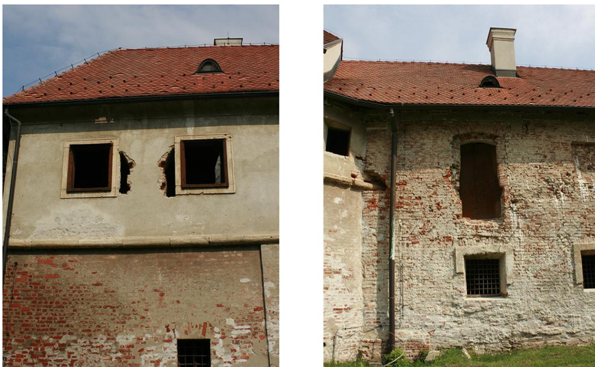
Slika 4.5. Pukotine u zidovima I. i II. dilatacije
