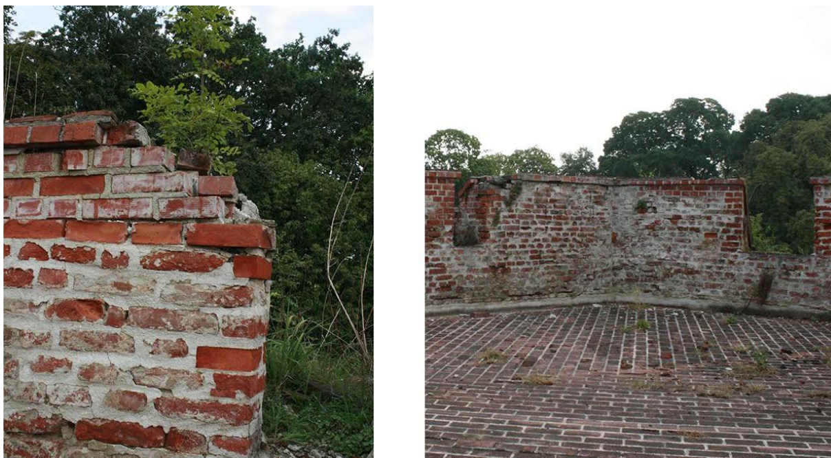
Slika 4.4. Oštećenje grudobrana SZ bastiona
