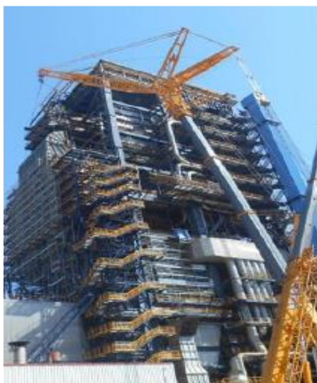
Slika 35. Prikaz DENOX postrojenja. [17]
