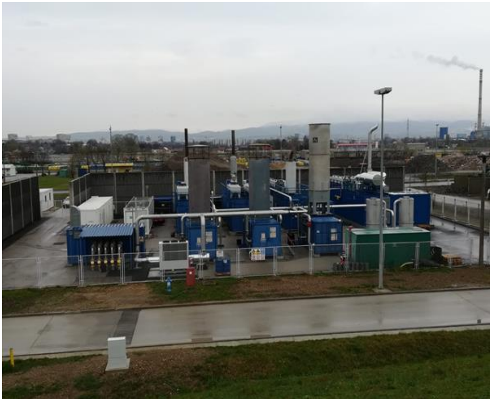
Slika 10. postrojenje za gospodarenje plinom
