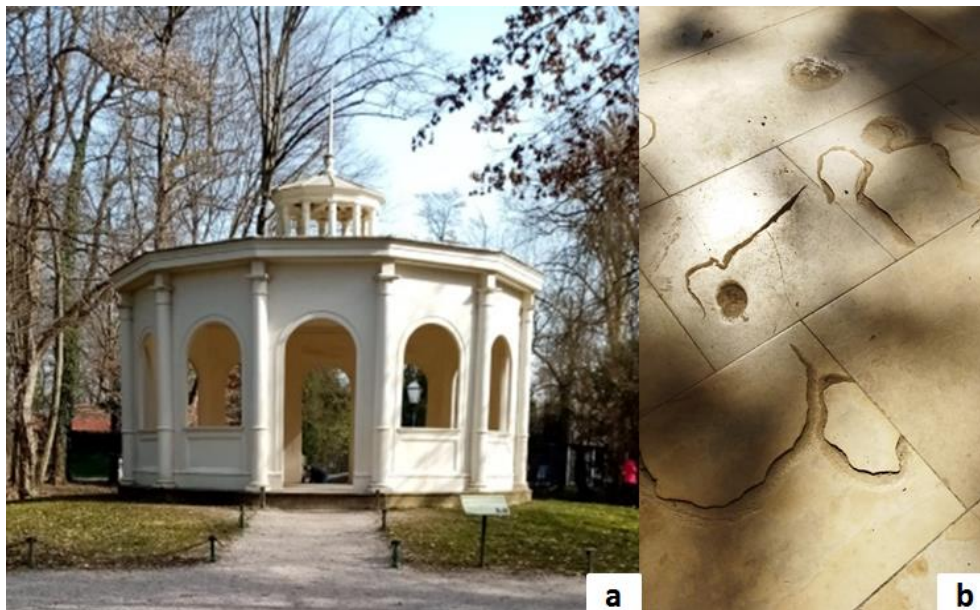
Slika 3.1.4.1 a) Paviljon Jeka; b) oštećenja na podu paviljona
