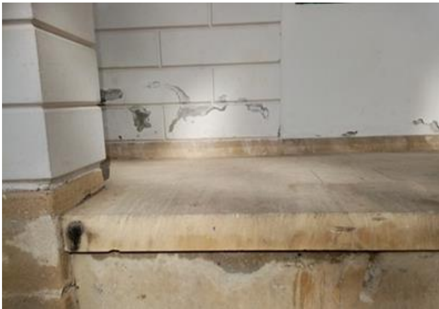
Slika 3.1.3.1. Oštećenja na vrtlarevoj kući: mrljanje vodom, ljuštenje filma i piling
