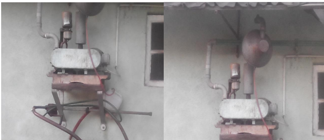
Slika 13. Podtlačna pumpa i filter zraka (Foto: Švub)
