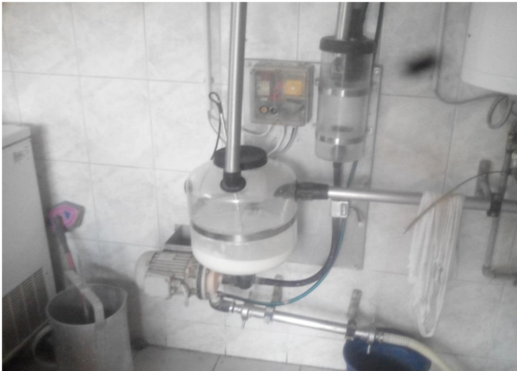
Slika 15. Prihvatna komora i sanitarni lonac (Foto: Švub)
