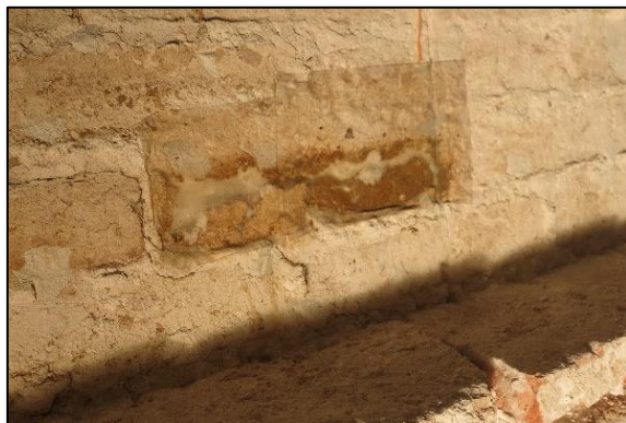
Slika 126. Gubitak slikanog sloja i žbuke na središnjem dijelu fragmenta zidne slike. Oštećenja nastala prilikom odvajanja opečnih blokova od žbuke privremeno su učvršćena japanskim papirom i akrilnom smolom Paraloid B72 .
