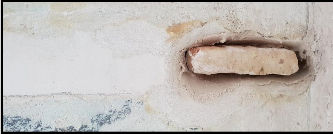
Slika 80 Detalj, umetnuti komad izvorne opeke na mjestu značajnog strukturnog oštećenja nosioca
