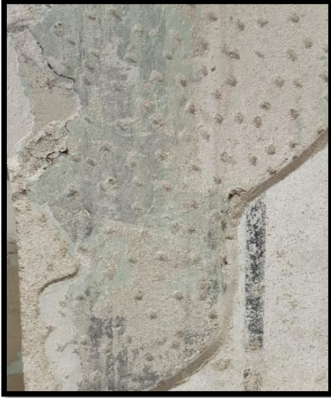
Slika 40 Prostorija 208, sjeverni zid, prikaz sloja starijeg oslika na mjestu oštećenja
