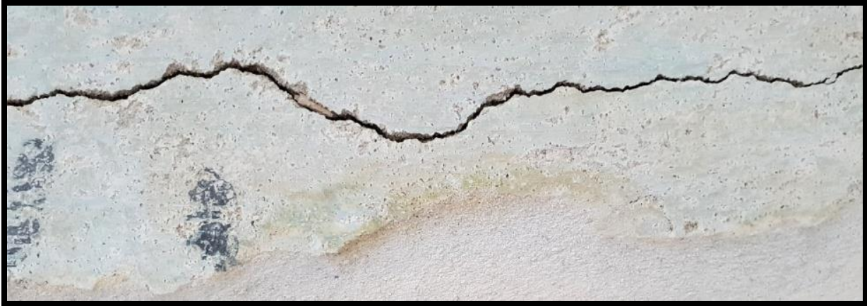
Slika 60 Drugi kat, prostorija 208, sjeverni zid, oštećenja ispod profilacije nastala od uvođenja elektrifikacije
