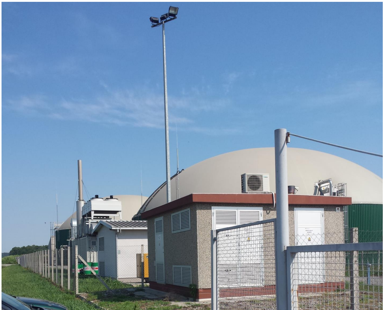
Slika 5.19. Transformatorska stanica 0,4/10 kV [fotografirano 8. lipnja 2015.]
