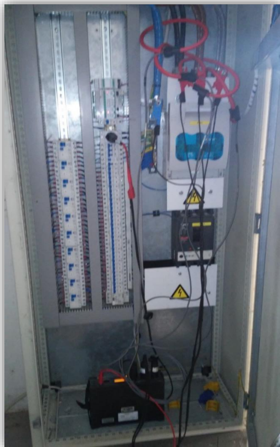
Slika 4.2. Uređaj Fluke 1745 spojen u GRO fotonaponske elektrane.
