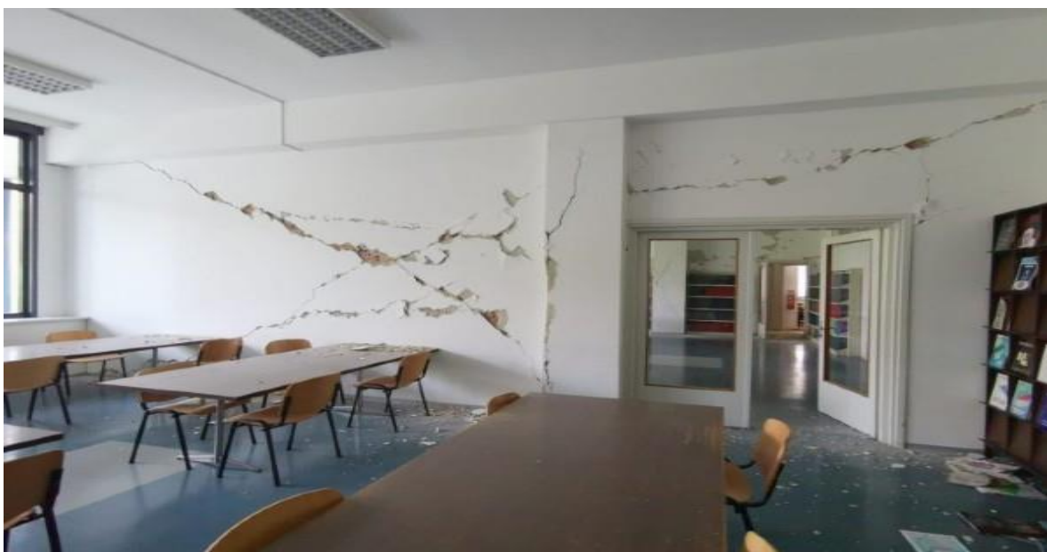
Slika 5. Oštećenje radi potresa – čitaonica SKM
