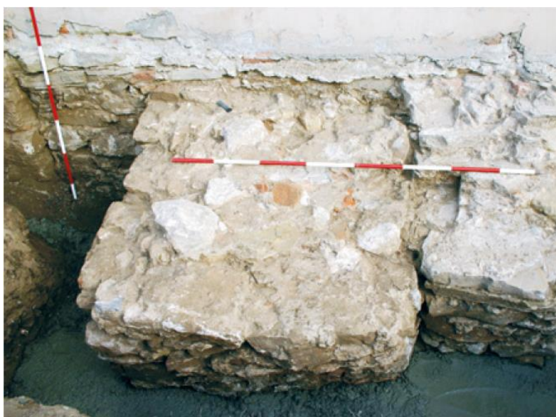
Slika 7 Crkva sv. Lovre, kontrafor južnog zida svetišta s dozidanom strukturom. Snimila 2009. B. Marcuiš 336 (Marijana Korunek, Branka Marcuiš, Josip Kovač, »Kapela i Trg sv. Lovre u Cirkovljanu«, u: Godišnjak Hrvatskog restauratorskog zavoda 6 (2015), str. 59)
