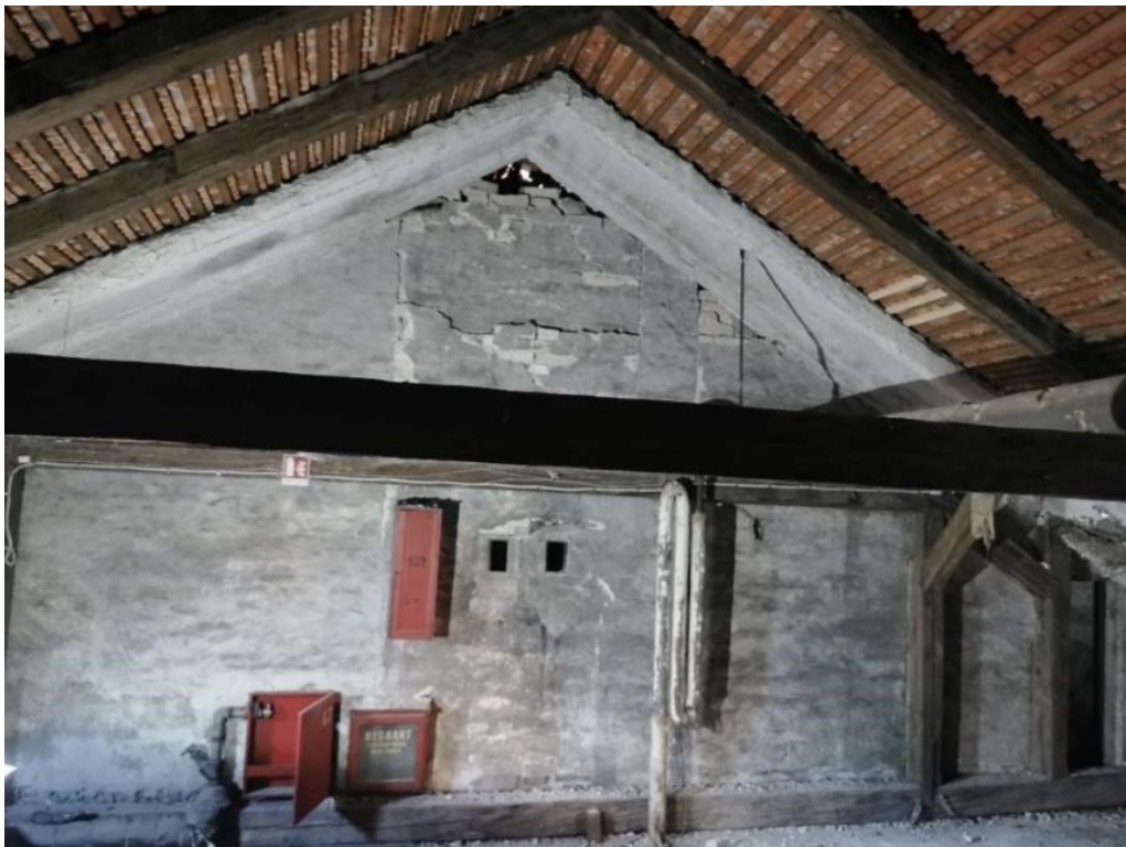
Slika 37.: Prikaz oštećenja vrha zabatnog zida u potkrovlju
