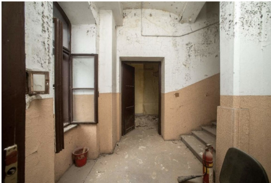
Slika 38.: Prikaz prisutnosti vlage na zidovima sjevernog stubišta
