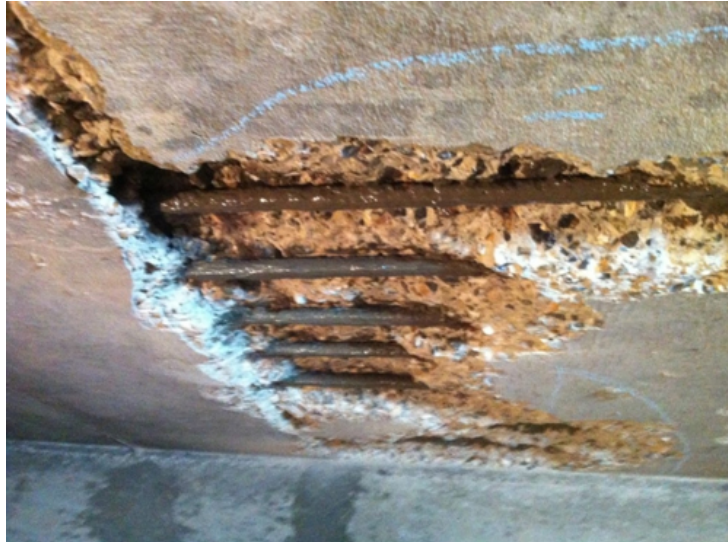
Slika 3: Prikaz korozije u armiranom betonu 7
