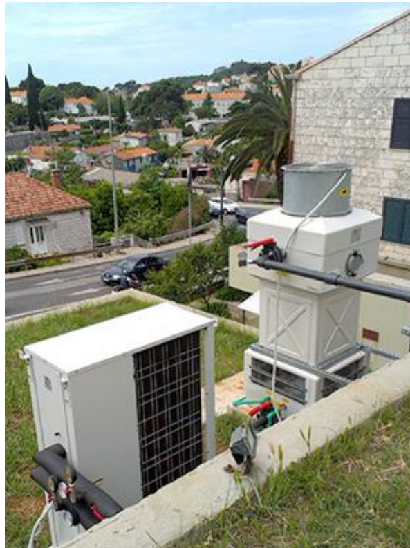
Slika 24. Dizalica topline i mokri rashladni toranj [41]
