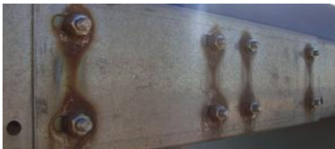
Slika 2. Galvanska (kontaktne) korozija [4]
