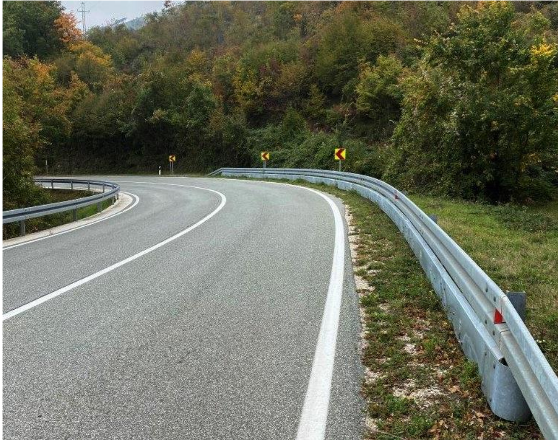
Slika 32 Primjer dodatne zaštitne ograde za motocikliste izvedene na čeličnu zaštitnu ogradu Izvor:[25]
