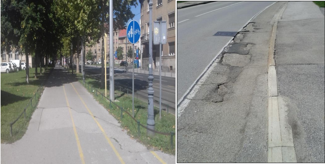
Slika 10. Nepravilna primjena prometnih elemenata i oštećenja [15]
