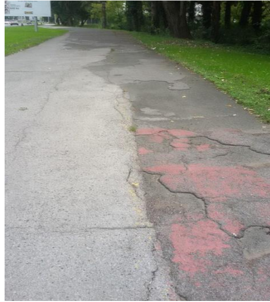
Slika 35. Oštećenje biciklističke staze Izvor: [15]
