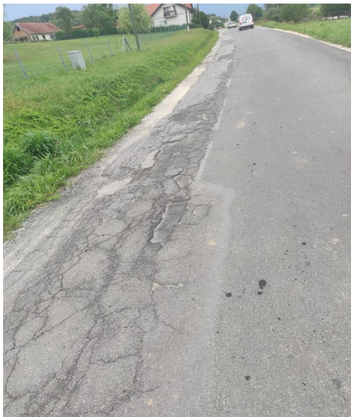
Slika 9. Primjer oštećenja kolnika lokalne ceste LC22053
