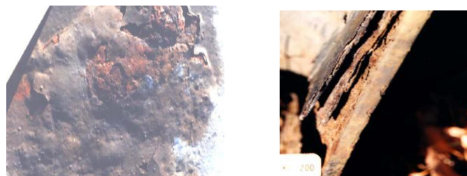
Slika 5. Bubrenje i listanje materijala kod potpovršinske korozije [4]
