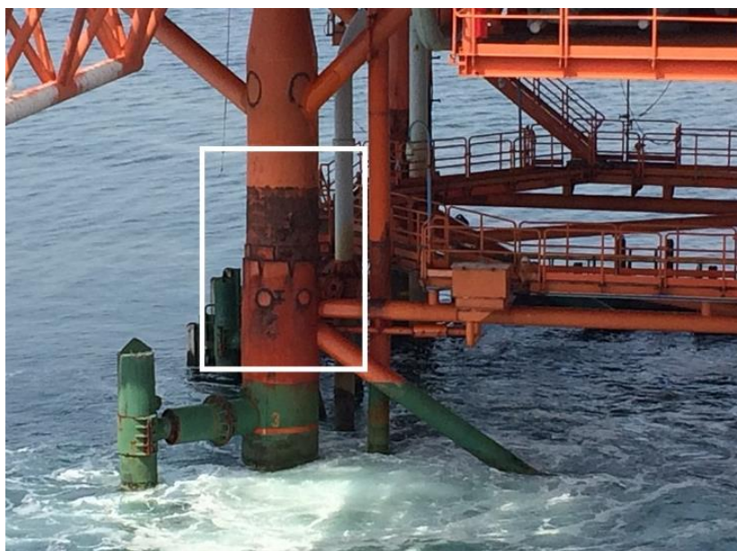
Slika 2. Korozija u zoni zapljuskivanja kod platforme Ivana K [2]
