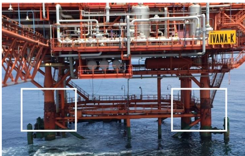
Slika 1. Korozijsko oštećenje na platformi Ivana K [2]
