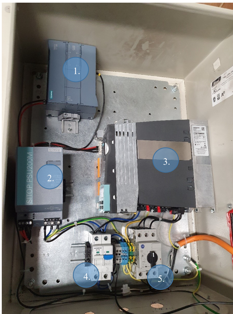
Slika 24. Sklop električnih komponenti. 1. PLC, 2. SITOP 24V istosmjerno napajanje, 3. frekvencijski pretvarač Sinamics S120 CU310-2, 4. osigurač napajanja, 5. motorna zaštitna sklopka
