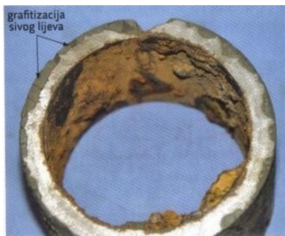
Slika 4. Selektivna korozija sivog lijeva [3]
