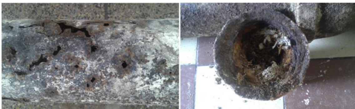
Slika 8. Primjeri učinaka korozije/biokorozije u cjevovodima [22].
