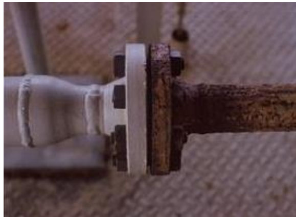
Slika 4. Kontaktna korozija na odobalnom postrojenju [5]
