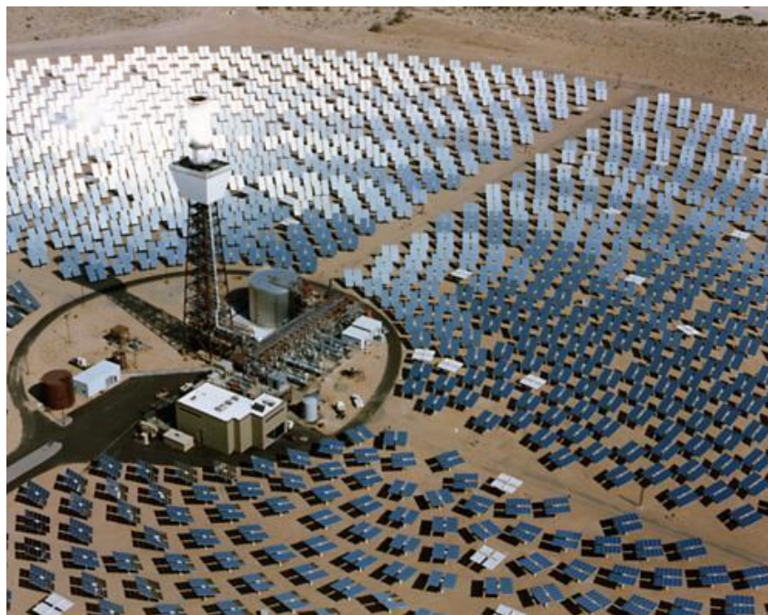
Slika 28. Centralni prijammnik na tornju i heliostatima
