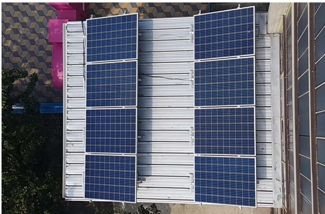
Slika 6. Sunčana elektrana od 2,16 kW
