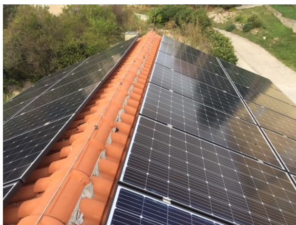
Slika 13. Fotonaponska elektrana na krovu desalinizatora [40]
