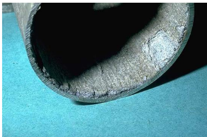
Slika 2.5. Morfologija interkristalne korozije unutar cjevovoda za vodu [5]
