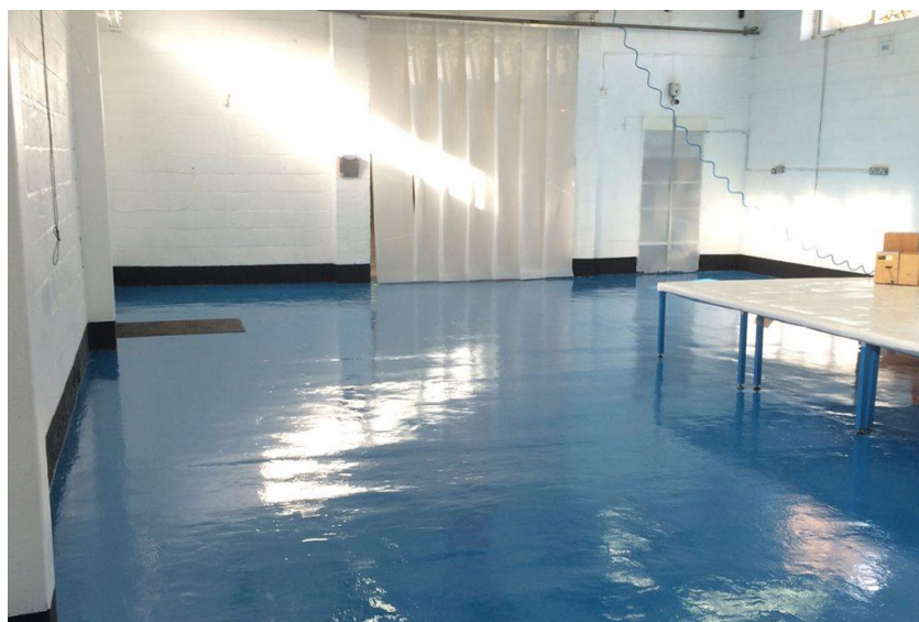
Slika 15. Pod od tekućeg epoksidnog premaza [25]
