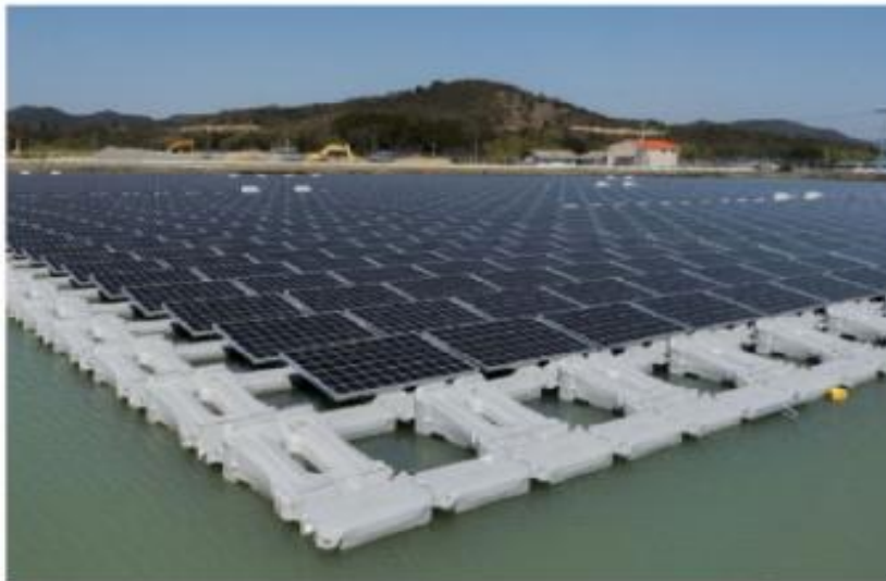
Slika 3.2 Primjer postavljenog FPV sustava iznad vode
