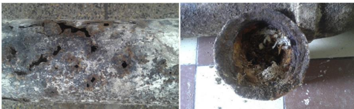
Slika 8. Primjeri učinaka korozije/biokorozije u cjevovodima [22].
