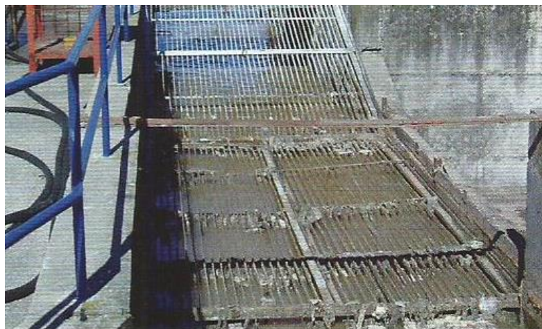
Slika 2. Grube rešetke na uređaju za pročišćavanje otpadnih voda
