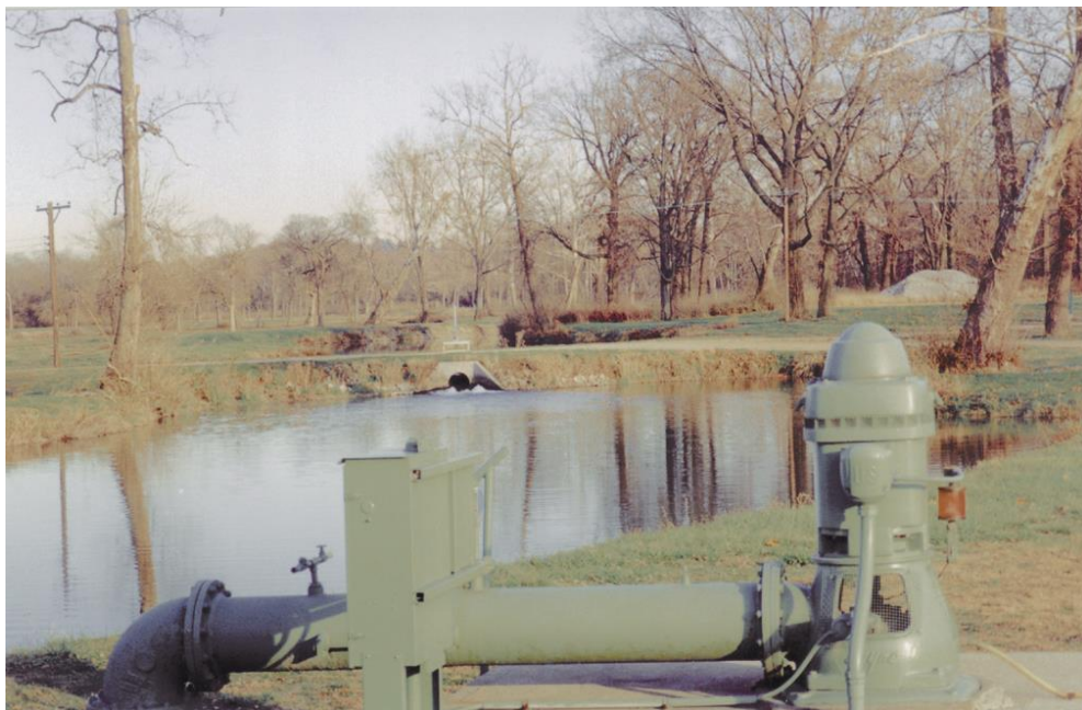
Slika 11. Turbinska pumpa velike snage instalirana na gradskoj bušotini na otoku Rohrers. (laguna prihranjivanja u pozadini) (Alley, M. et al., 1999)
