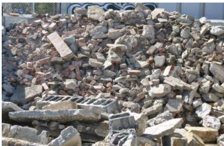
Slika 1. Šuta nastala tijekom rušenja [3]
