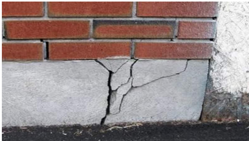
Slika 23 Oštećenja građevine uslijed uzdizanja glinenog tla
